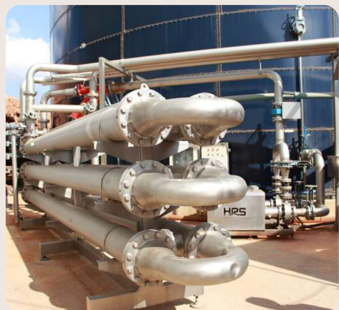
Intercambiador de calor para recuperación de energía en el proceso de la EDAR
